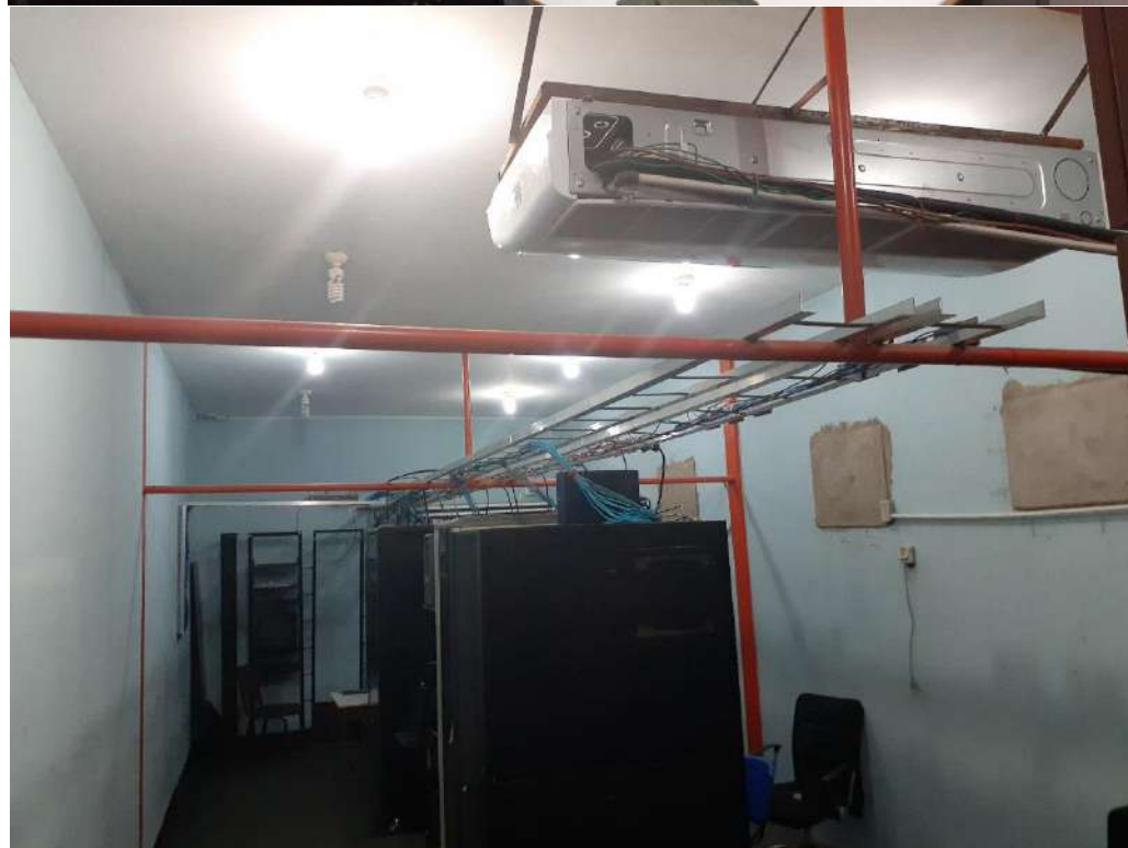
Falta protector para aire de 5 toneladas. Apagado por la falta del protector.
